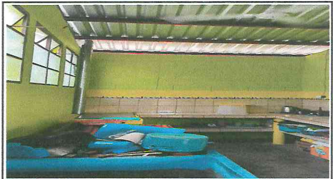
Foto 2: Chimenea de metal
