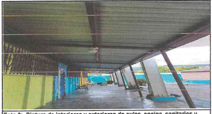
Foto 6: Pintura de interiores y exteriores de aulas, cocina, sanitarios y sus al rededores.
